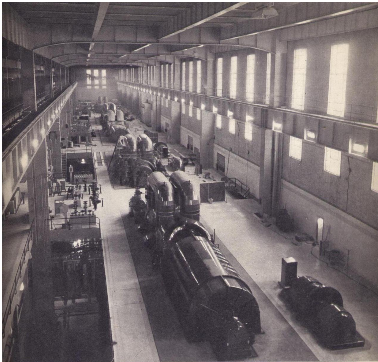
Turbinas de vapor en una central eléctrica moderna.
